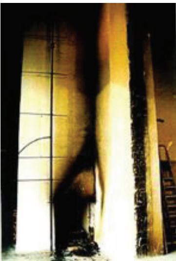
Daños en la muestra de ensayo: enlucido de acabado
