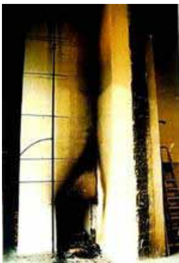
Zniszczenia próbki: końcowy efekt uszkodzenia elewacji
